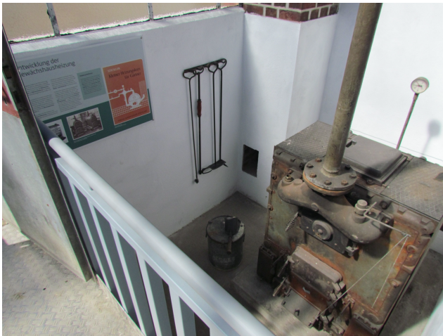
Abb. 6: Koks befeuerter Buderus Heizkessel C 40 im Kesselraum des Verbindergewächshauses aus Rechtenbach, 2019 © Freilichtmuseum Hessenpark.
